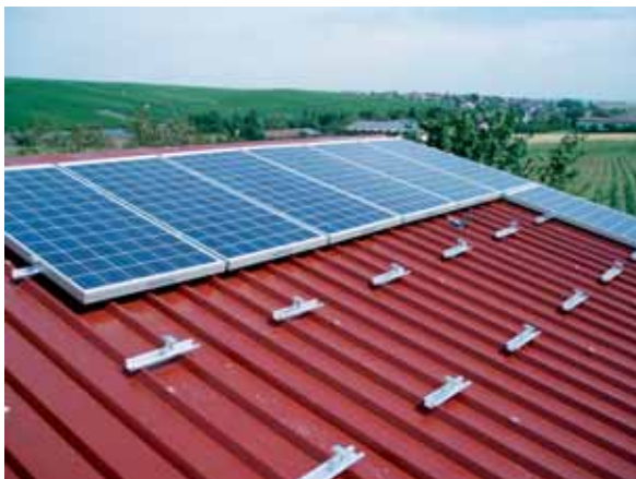
Les profilés TRI-VENT sont rivetés au toit aux endroits nécessaires à la fixation des panneaux.
